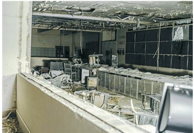
蒸汽管道爆裂事发地受蒸汽冲击破坏，现场一片狼藉
